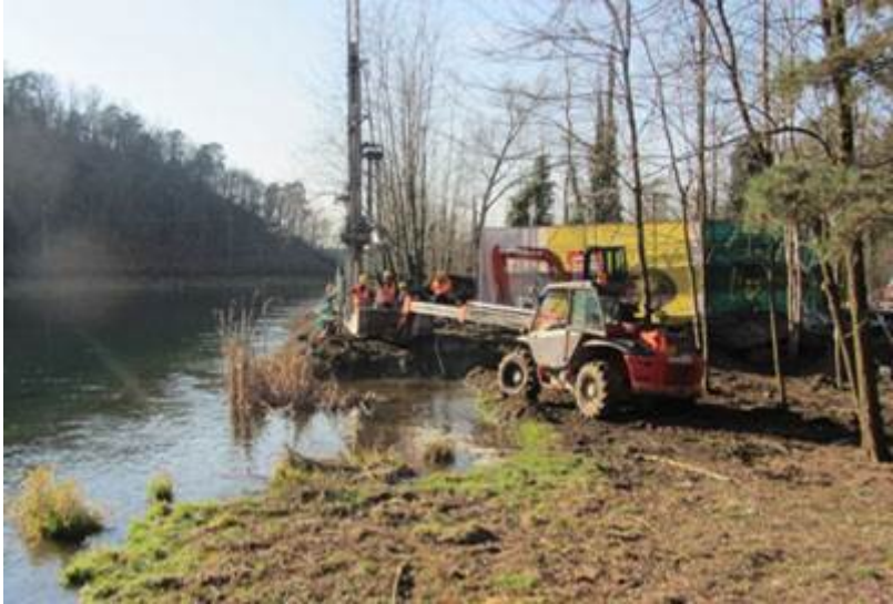
La realizzazione delle colonne di jet grouting per il consolidamento del rilevato arginale in sponda destra del bacino del Panperduto in prossimità del nuovo Museo delle Acque Italo-Svizzere
